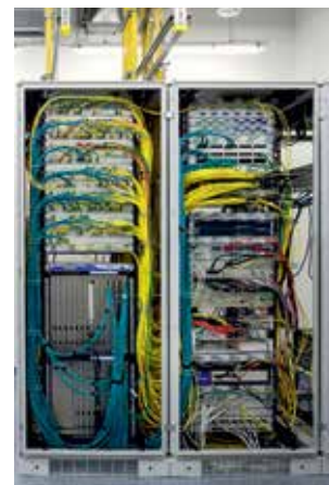
Serverraum – hier laufen alle Informationen zusammen
